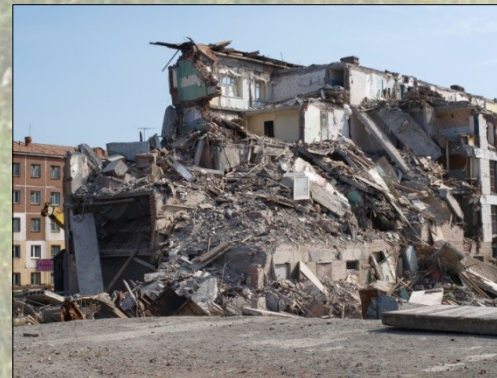
Снесенный аварийный жилой дом
